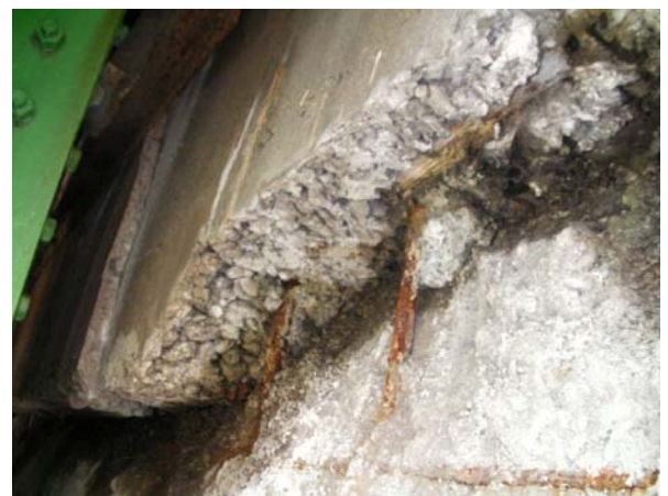
写真-1 コンクリートのはく離と鉄筋露出
