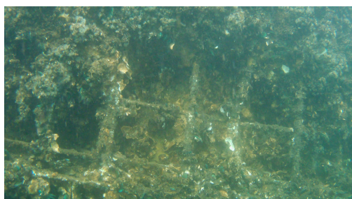
写真-2 ROV による調査結果（上部工の鉄筋露出）
