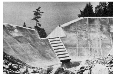
写真-1 溪流に設置された盛土形式の土石流対策工の外観 （カナダ；チャールズ・クリーク） 4)
