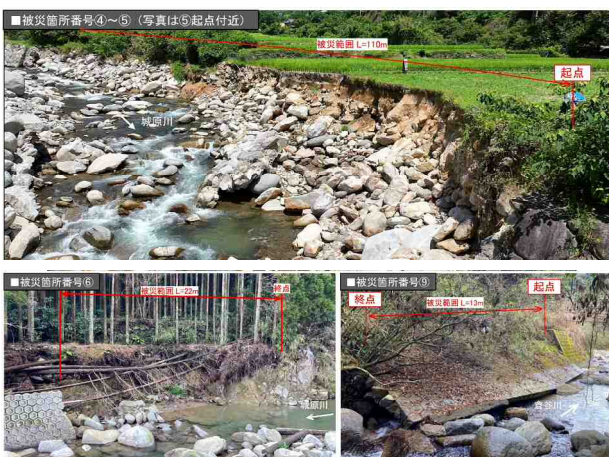
図-2 城原川ダム被災状況
