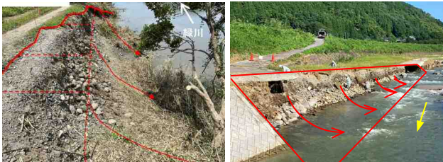
図-1 護岸被災状況
