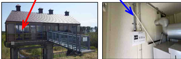
図-7 耐震部材（左：操作室、右：発電機室）
