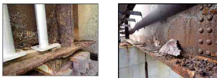
写真-1 局所的な著しい腐食の状態
